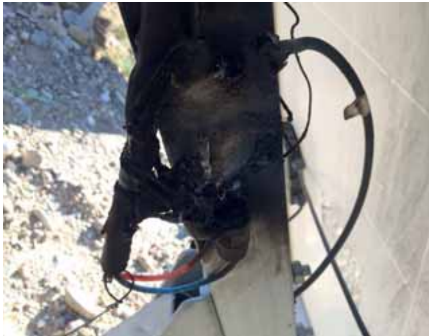
连接器烧毁现场照片
